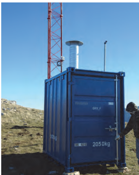
Power:Container - Autarke Energieversorgung für entlegene Standorte
