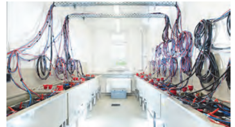
Wasserbäder Batterieprüflabor am Standort Pöhlde
