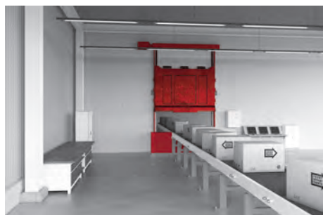
Feuerschutzabschluss im Zuge bahngelagerter Förderanlagen
