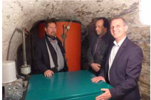
Die Herren Stieler, Bollmann und Merker am Blockheizkraftwerk im Hotel „Die Tanne“ (v.l.)
